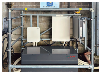
おうち給電システム (本社)
