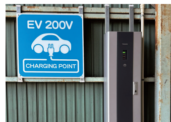
電気自動車用充電器 (小牧センター)
